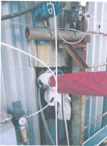
废气（12#机组）监测照片
