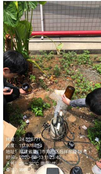
W1 厂区内地下水监测井
